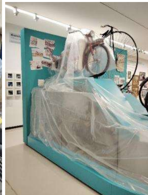
実際に展示室に漏水があった際、ビニルカバーをかけた様子
